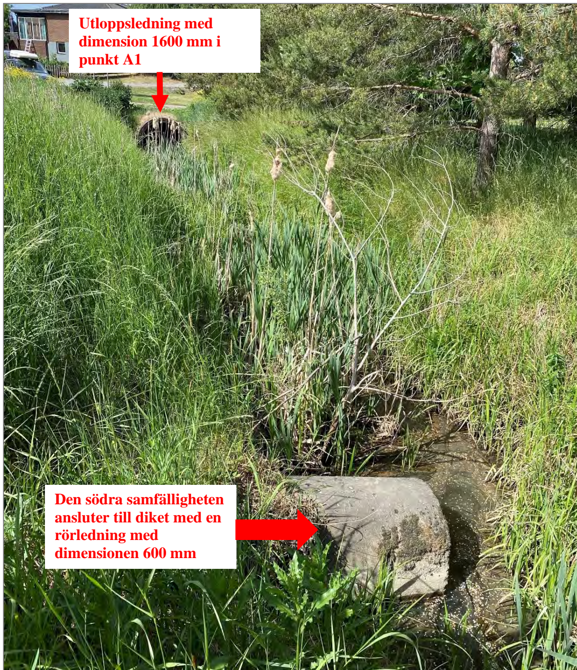
Figur 2-4. Utloppsledning med dimension 1600 mm belägen i punkt A1. 20 meter uppströms ansluter den södra samfälligheten till DDAF:s dike.
